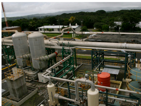
Alfredo Huerta Proyecto Geotérmico Miravalles I, ICE
