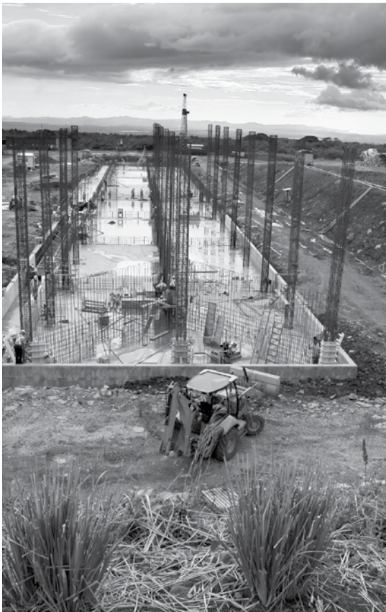
Proyecto Geotérmico Las Pailas. Guanacaste, Costa Rica
