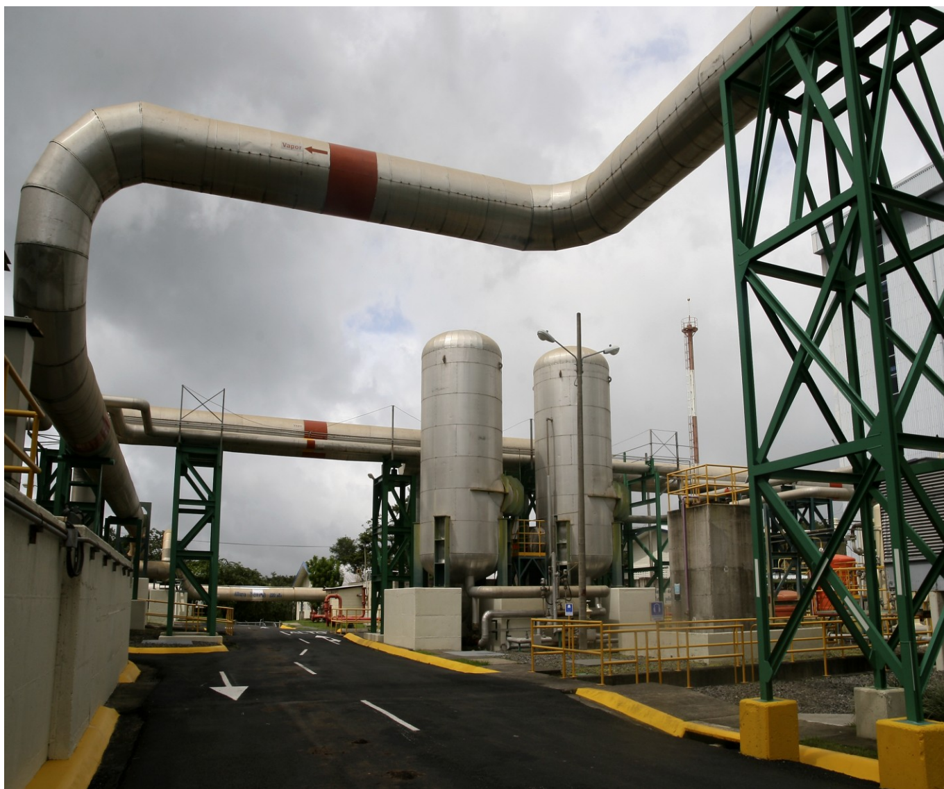
Proyecto Geotérmico Miravalles I
