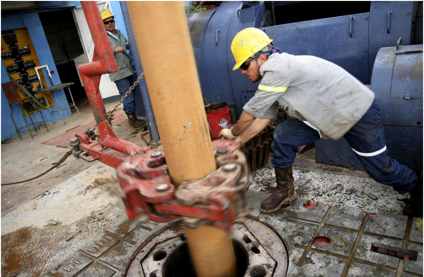
Colocación de la extensión de 12 m para la barrera de puntas de tungsteno dentro de la estructura del pozo. Proyecto Geotérmico Las Pailas, Rincón de la Vieja, Guanacaste
