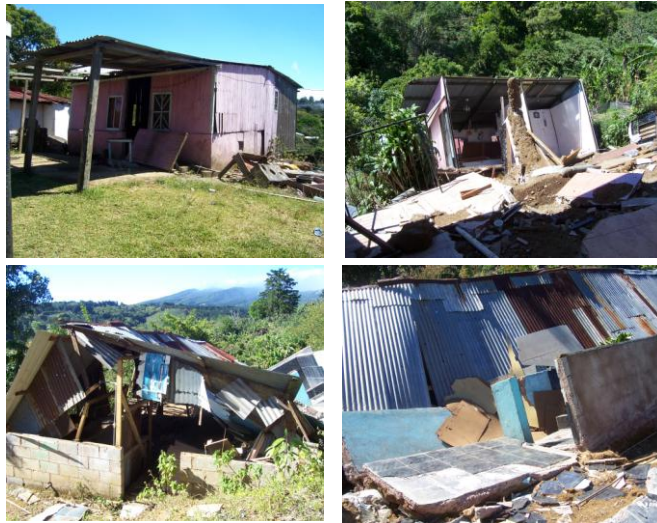
Viviendas dañadas por el efecto combinado de problemas estructurales y su ubicación inapropiada.
