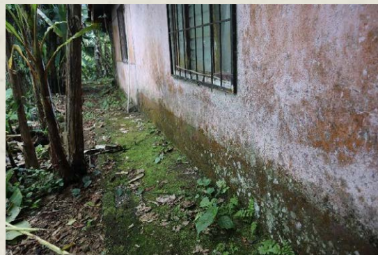
Figura 23. Cara externa del muro CBSW sin mantenimiento, mostrando evidencia de humedad
