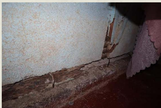
Figura 20. Montantes de madera y placa de base completamente descompuestos por termitas.
