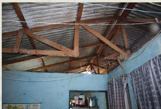
Figura 21. Cercha de techo de madera retrasada por termitas.
