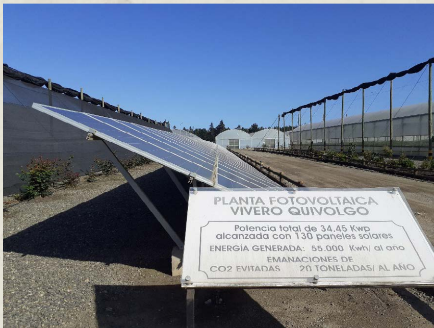
Planta fotovoltaica en el vivero Quivolgo de la empresa chilena Arauco, 2019.
