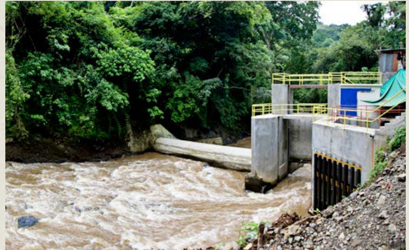
A. Baltodano. Proyecto Hidroeléctrico Tacares, Alajuela.
