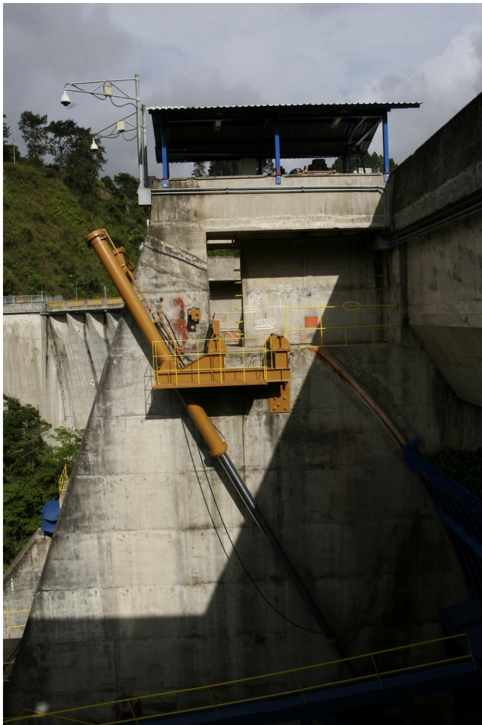
Planta hidroeléctrica Cachi
